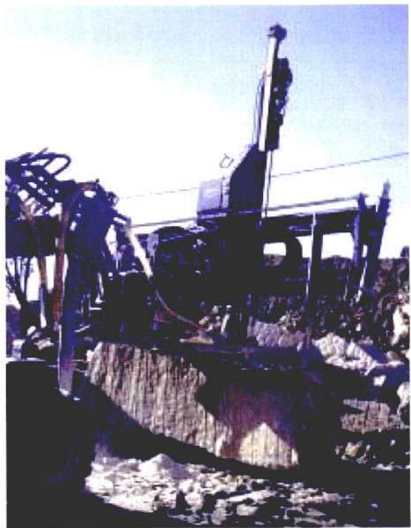
Fotografía 3.10.2. Perforadora multimartillo utilizada aquí para la realización de taladros para subdividir un semibloque.
